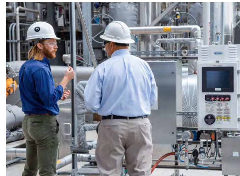
Un analyseur Raman (dans le boîtier à droite) permet de surveiller et de contrôler avec précision l'injection d'hydrogène.
