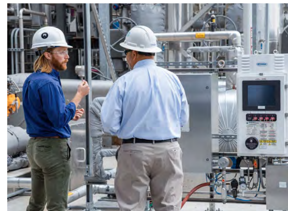
Un analizador Raman (derecha) permite monitorizar y controlar con precisión la alimentación de hidrógeno.
