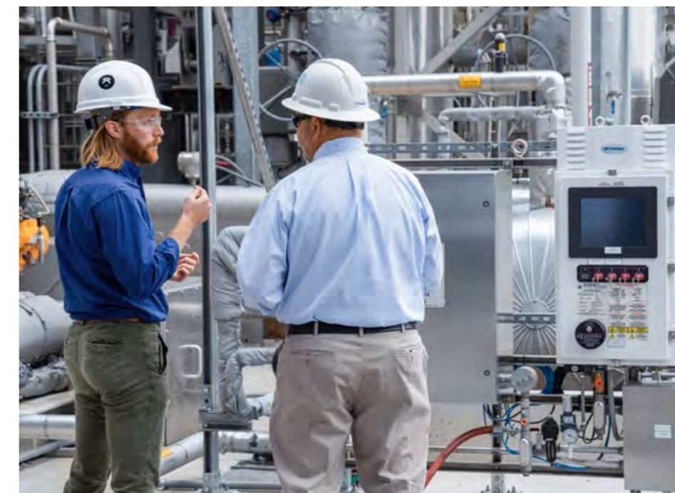
Mit einem Raman-Analysator (im Gehäuse rechts) lässt sich die Wasserstoff-Einspeisung überwachen und exakt steuern.
