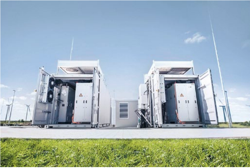
Los electrolizadores de la compañía H-Tec Systems tienen una estructura compacta: en unos contenedores móviles, unos stacks PEM generan hidrógeno eficientemente.
